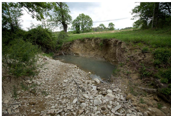
Et toujours des faciès d'érosion de berge, à proximité immédiate de la route.
