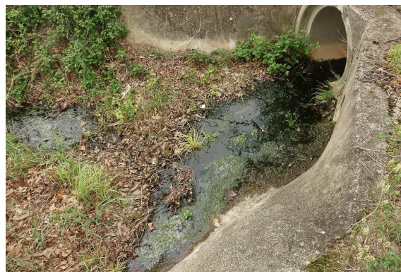
Eaux polluées au passage sous la route d'Uzès (D 981).
