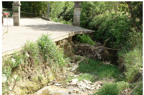
Erosion marquée : problème d'espace de liberté latéral du cours d'eau.
