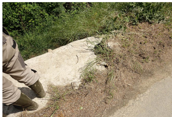
Buse de passage sous la route et problématique d'érosion.
