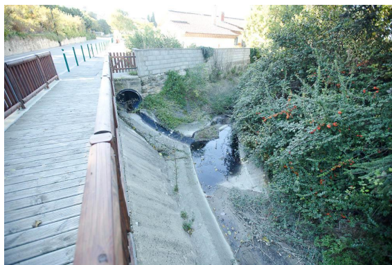
Rejet d'eaux usées juste en amont de la zone humide.
